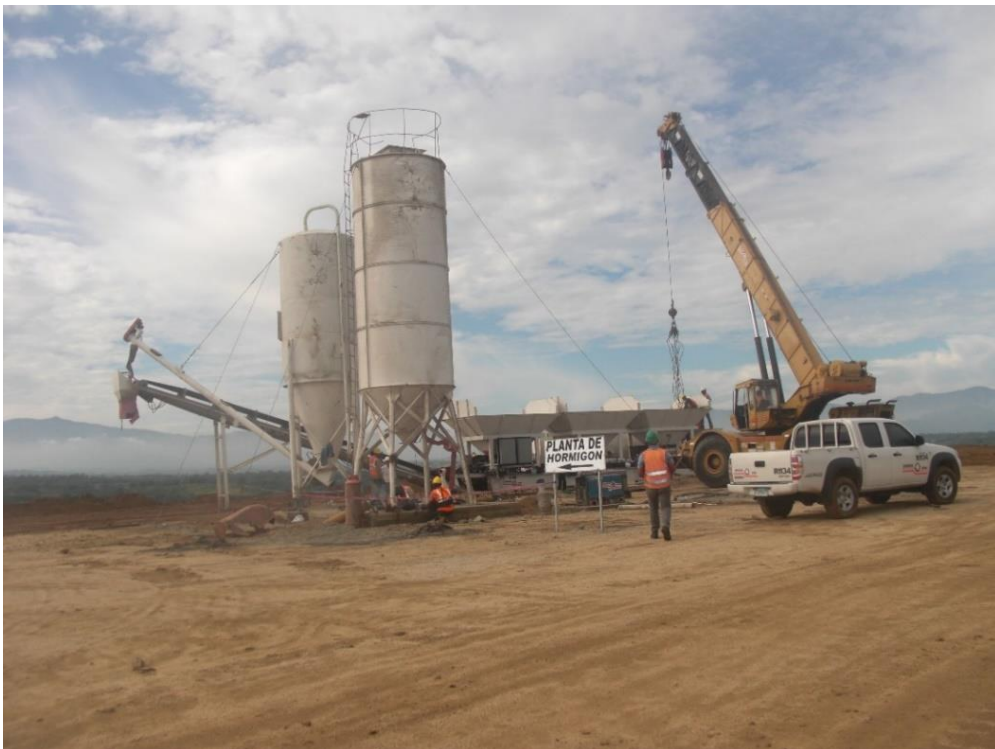
Planta Producción de Hormigones
