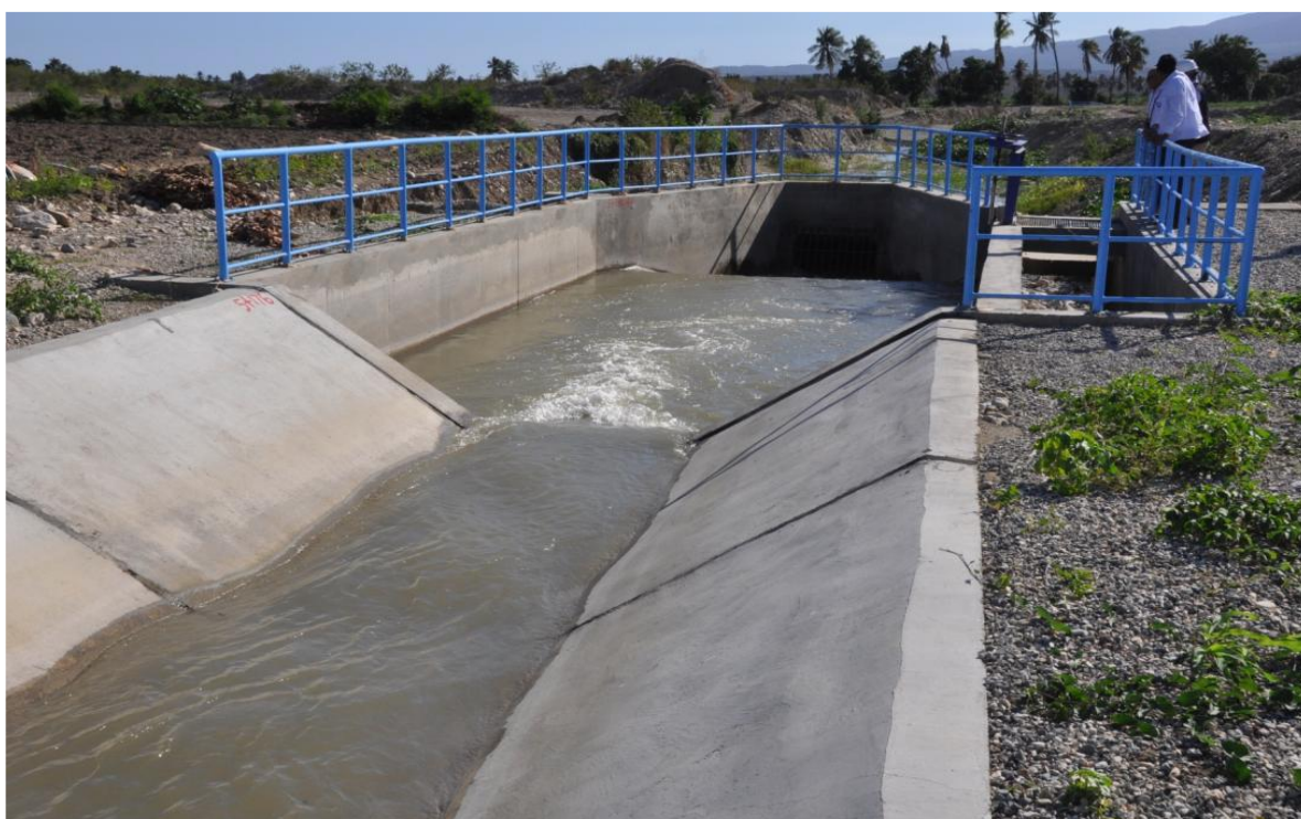
El sifón del canal Ysura, en Azua, construido para mejorar la eficiencia de riego de este sistema que irriga la mayor parte de las tierras bajo producción del Valle de Azua.
