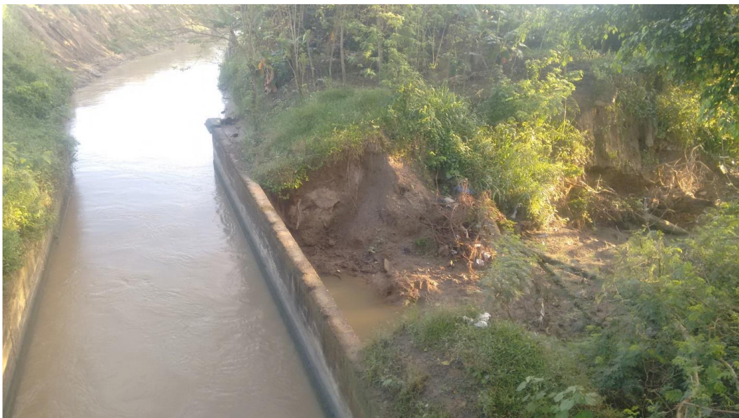
Erosión próximo a la Toma del Canal Camú, La Vega
