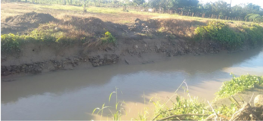
Erosión Muro de Gaviones, Canal Camú entrada Jamo La Vega
