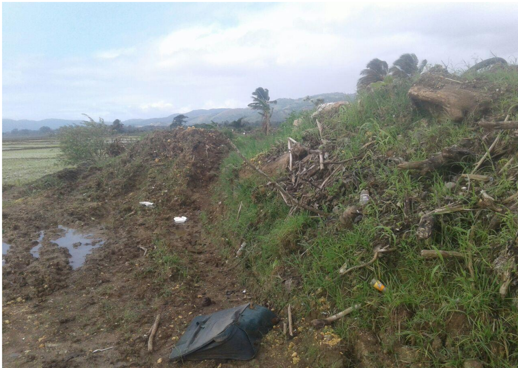
Rotura muro rio Riote, Ma.Trinidad Sanchez
