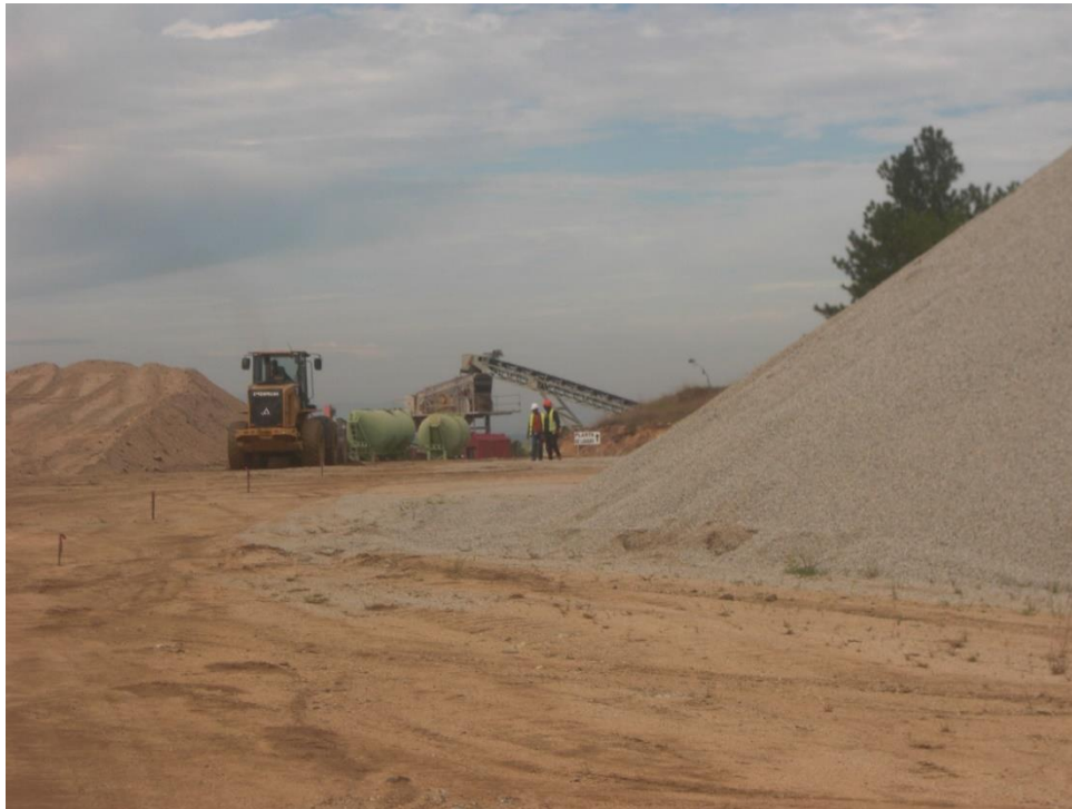
Planta procesadora de agregados
