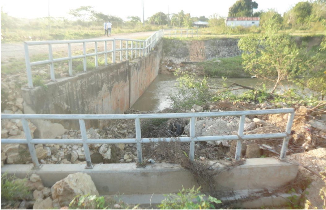
Alcantarilla de cajón con cabezal en salida dique al CC-1
